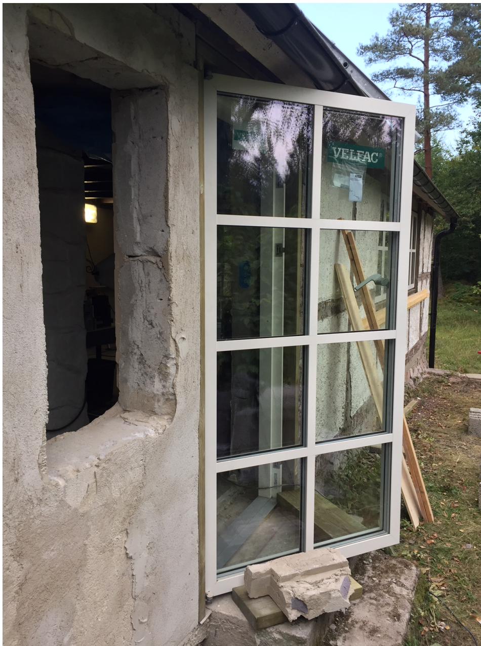
Figure 7: Ja der har faktisk været et kæmpe hul i huset. Men det er muret til — vi behøver jo ikke vinduet når vi har fået en glasdør.
